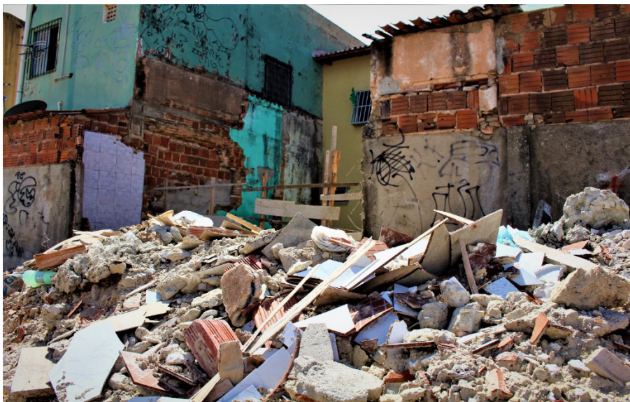
Foto 12 – Entulhos e casas abandonadas, Bairro Vicente Pinzon
