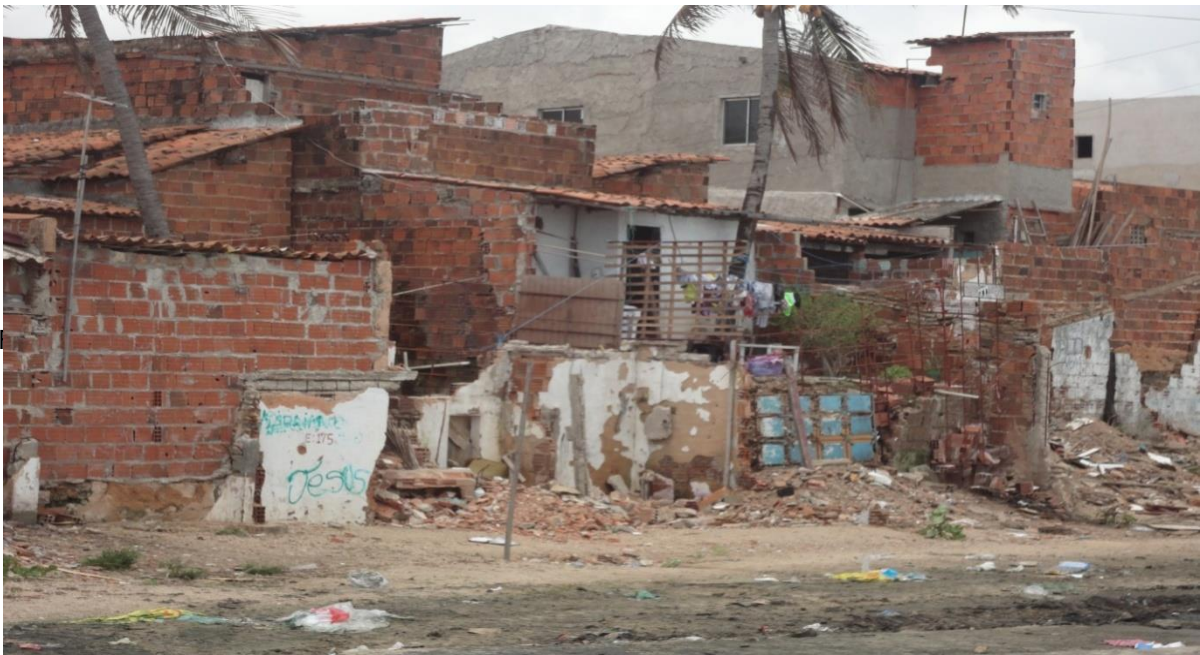
Figura 4 – Imóveis em situação de risco – Pirambu
