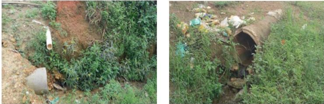
Figura 12- Fotos mostrando as deficiências na rede de esgoto no centro da cidade do Oiapoque
