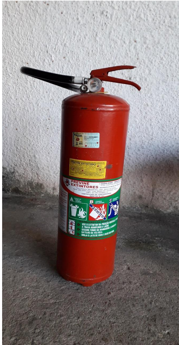
Figura 15 – Extintor de água
