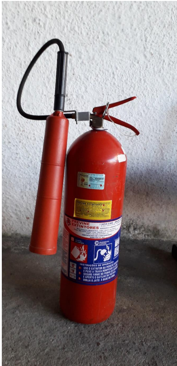
Figura 17 – Extintor de CO2
