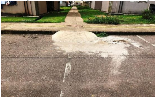
A) Construção irregular de rampa
