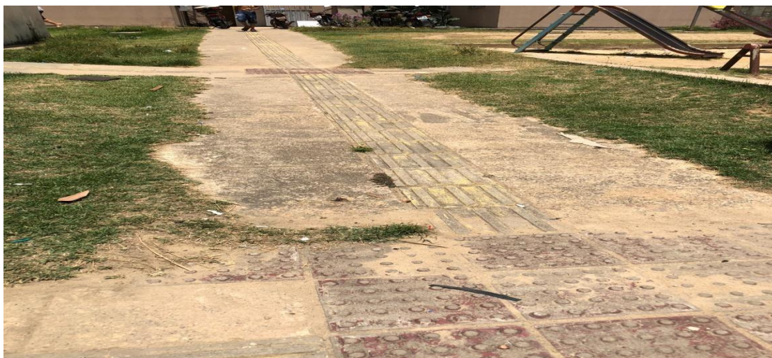
C) Piso deteriorado por agentes físicos
