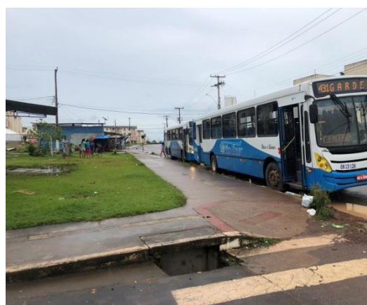
D) Ausência de grade de proteção
