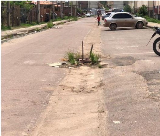
C) Vias sem grade de proteção
