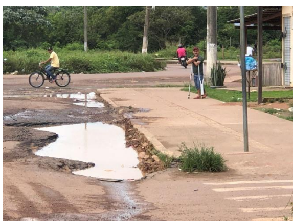
C) Ponto de ônibus sem infraestrutura
