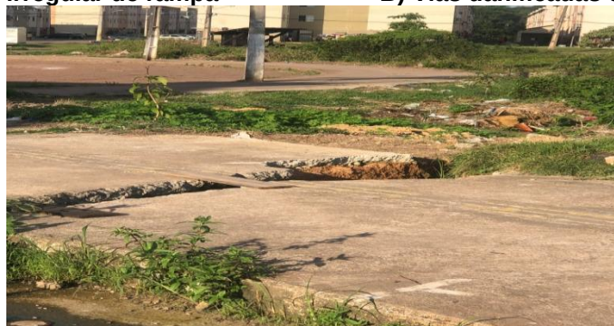
C) calçada danificada
